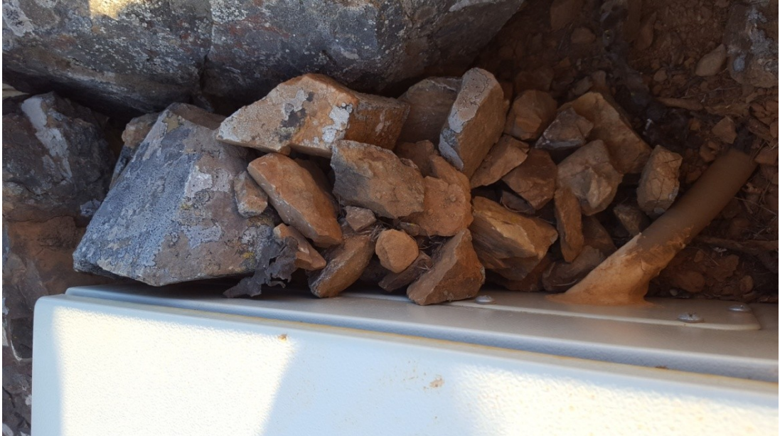
TTRL : Nouveau câble d'antenne (étanchéité assurée par scotch extensible) + couche terre/roche pour bloquer le passage des rongeurs.
