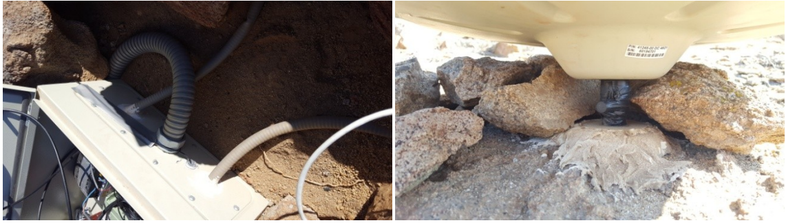
MMOR extrémités des gaines. Etat de la connexion sous l'antenne GPS
