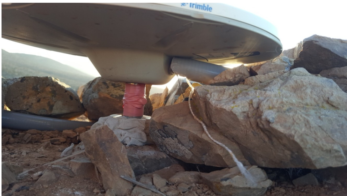
TTRL: Extrémité de la gaine au niveau du raccord de l'antenne
