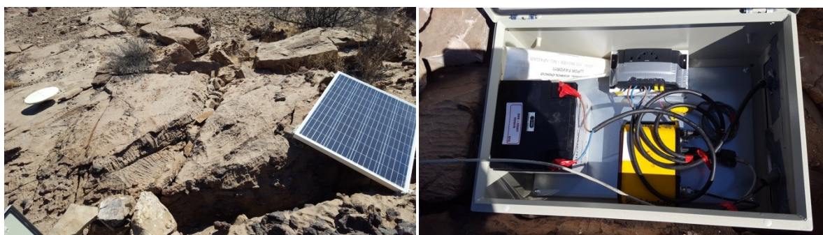
TOT5 après nettoyage du panneau solaire et l'état interne de la boîte contenant la batterie, le régulateur, et le Trimble Net-RS.
