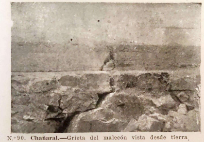
N.º 90. Chañaral.—Grieta del malecón vista desde tierra.
