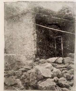
N.º 34. Vallenar.—Casa de un piso. La parte de adobos completamente destruido
