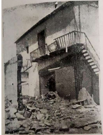
N.º 32 Vallenar.—Una casa de dos pisos en pie N.º
