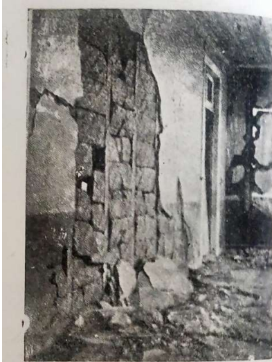
N.º 30. Vallenar.—Tabiques del Instituto Comercial dañados por el terremoto
