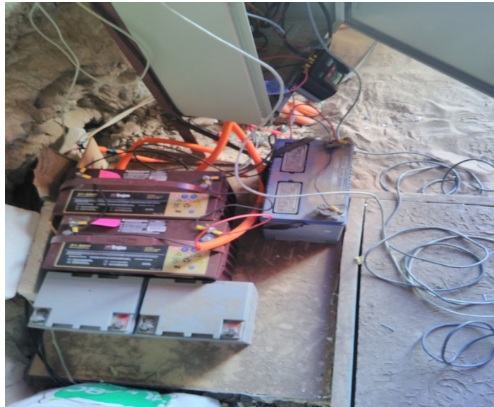
Photo3: Les batteries gels rouges ont été installées par le CSN lors d'une visite de la station...
