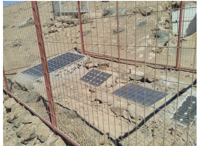
Photo2: Panneaux solaires recouverts d'une fine couche de sable.
