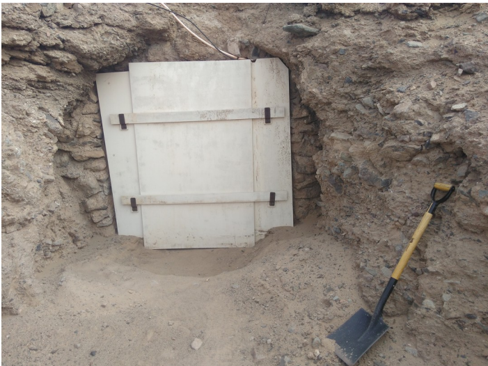
Photo14: Enlèvement du sable bloquant la porte de la station.
