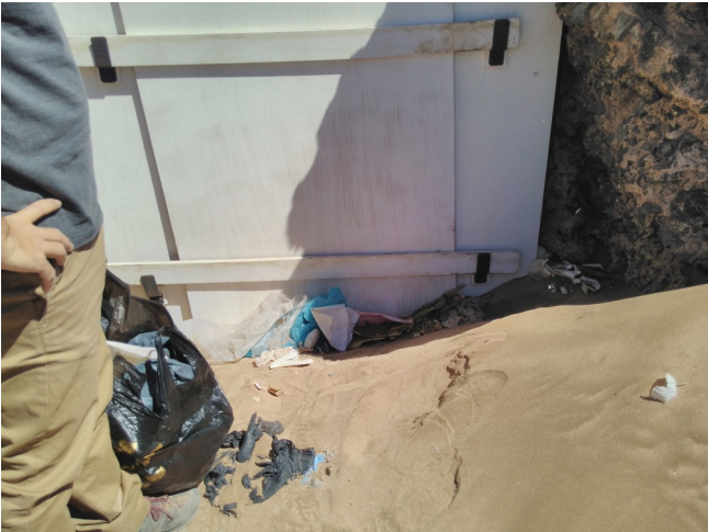
Photo1: Entrée encombrée par l'accumulation de sable et de sacs plastiques.
