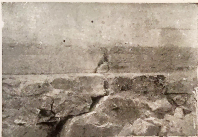
N.º 90. Chañaral.—Grieta del malecón vista desde tierra.
