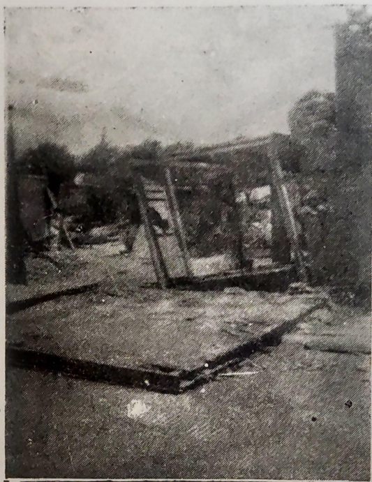
N.º 33. Copiapó.—Tabique caído
