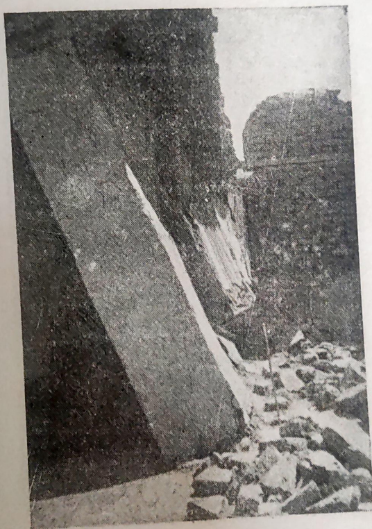
N.º 23. Copiapó.—Cárcel. Muro movido en su base y en seguida abatido
