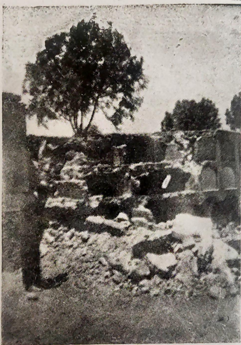
N.º 45. Copiapó.--Nichos de bolones y concreto con poco cemento
